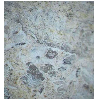
微細な連続空隙(クラック)を閉塞したRCガード (1,000倍)
