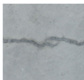
拡大すると、微細なクラックが RCガードPKで閉塞されているのが分 かります。
