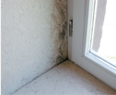
サッシ廻りの気密不足によるカビ発生の様子
