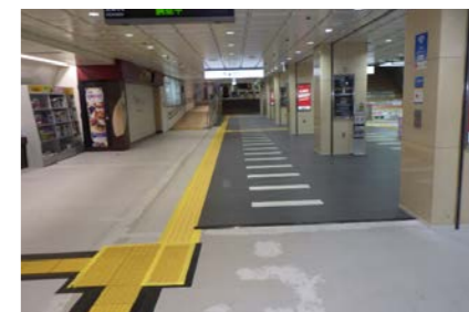
仕上げ材の「ノラメント」を段階的に張っている状況。目地がないため汚れが付着しにくく、清掃の負担も軽減される。ケミクリートMS・Lとノラメントは、それぞれ厚さ3mm、3.5mm。計6.5mmなので床端部のすり合わせもしやすい
